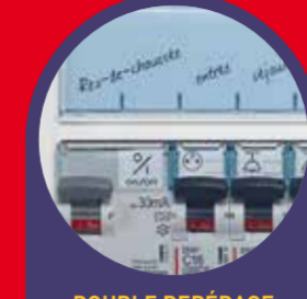
DOUBLE RÉPÉRAGE DES CIRCUITS
