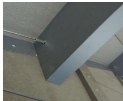
Panne alu à percer pour passage du câble
