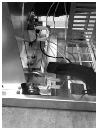
Fig. 74 - Nettoyage de le ventilateur ambiant
