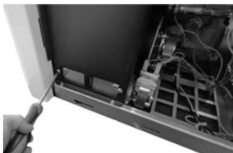
Fig. 107 - Nettoyage de le ventilateur ambiant
