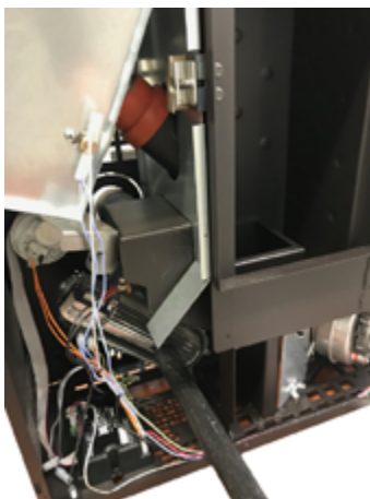
Fig. 102 - Nettoyage de le ventilateur ambiant
