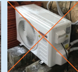
pose non conforme
