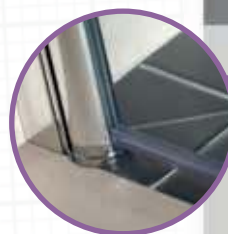
Le côté extérieur du profilé tombe repose sur le joint du carrelage.
